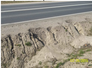
Skarpy, pobocza rozmycia do uzupełnienia
