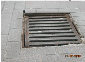
Kratki ściekowe , pokrywy włazów zaniżenie lub zawyżenie względem nawierzchni o 0,5 cm do regulacji
