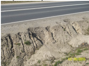
Skarpy, pobocza rozmycia do uzupełnienia
