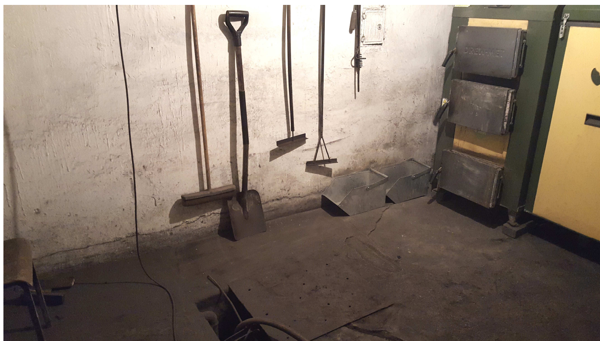
Rys.8 Pomieszczenie zawilgocone w piwnicy budynku szkoły – kotłownia (rejon otworu nr 8).
