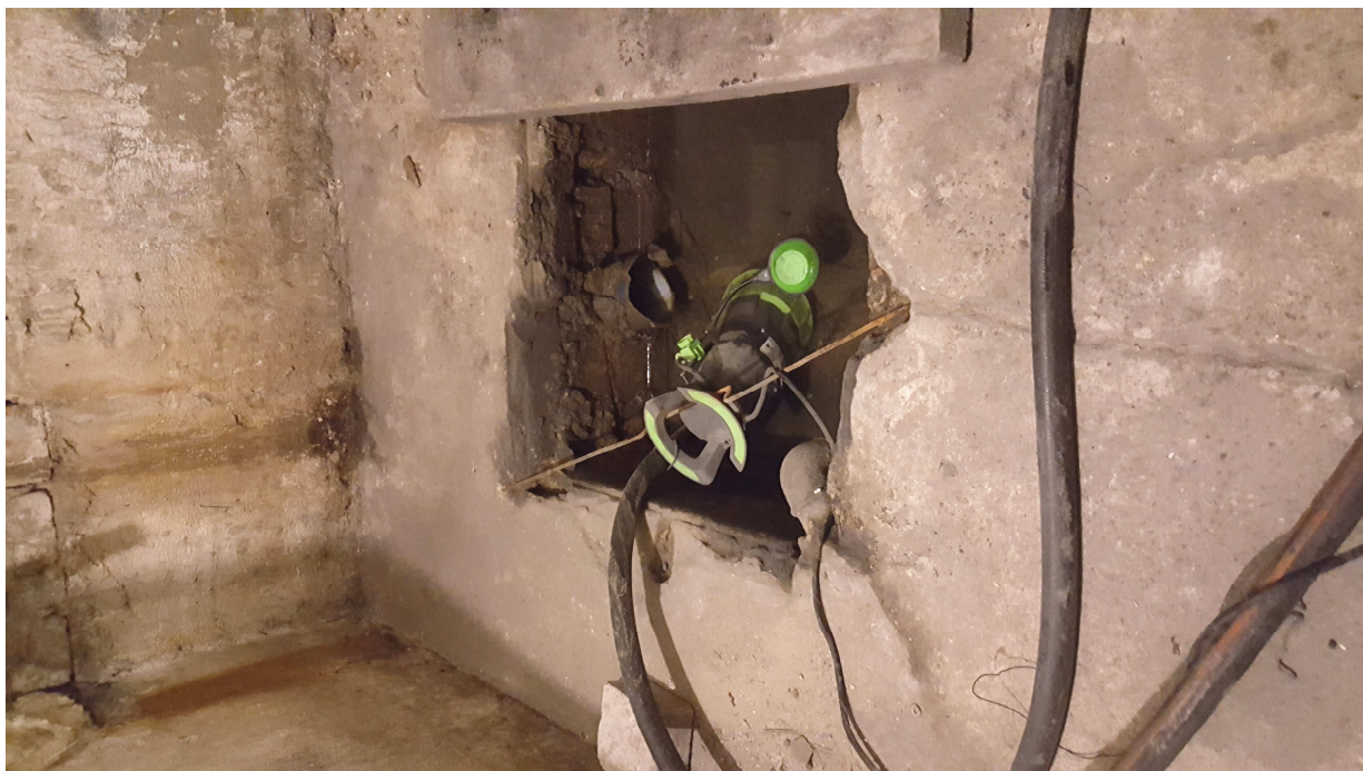
Rys.5 Pomieszczenie zawilgocone w piwnicy budynku szkoły w rejonie otworu AII.
