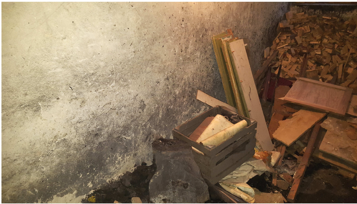
Rys.7 Pomieszczenie zawilgocone w piwnicy budynku szkoły – kotłownia (rejon otworu nr 8).
