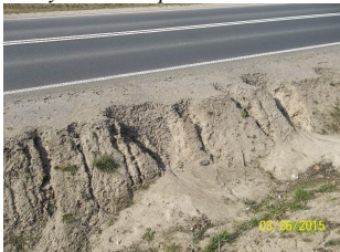
Skarpy, pobocza rozmycia do uzupełnienia
